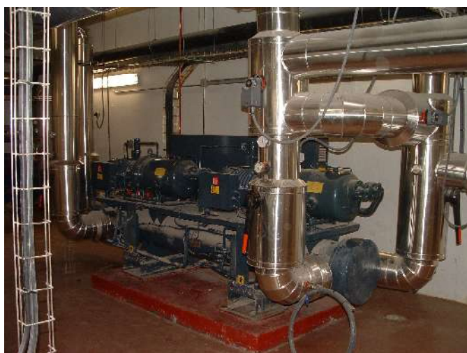
Unidad enfriadora reversible - Sótano 2
