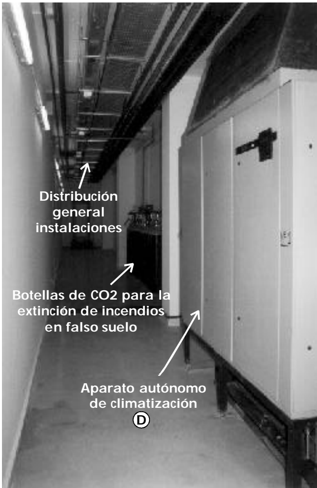
VISTA DEL PASILLO DE INSTALACIONES DEL CENTRO DE CALCULO
