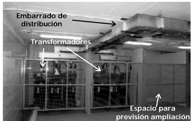
VISTA GENERAL CENTRO DE TRANSFORMACION
