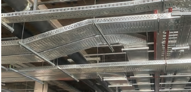
Instalaciones por techo nivel -1
