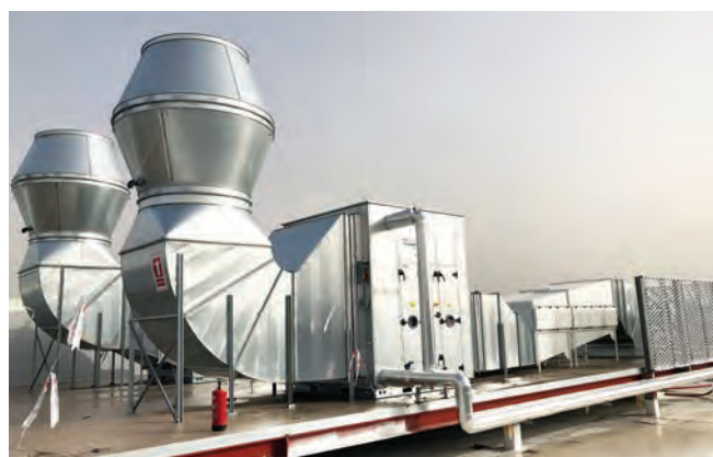
Descarga aire con filtros H14
