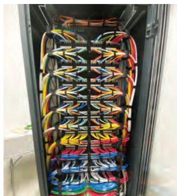
Armarios de comunicaciones del hotel.
