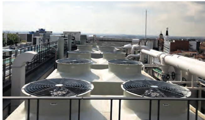
Vista ventilación forzada torres de refrigeración de hotel y comercial en cubierta edificio.
