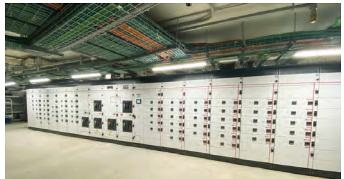
Cuadro general de baja tensión del hotel
